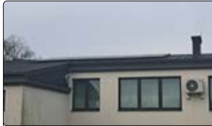
Instalacja fotowoltaiczna OSP Olszewka
