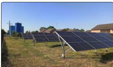
Instalacja fotowoltaiczna przy hydroforni w Jednoróźnie
