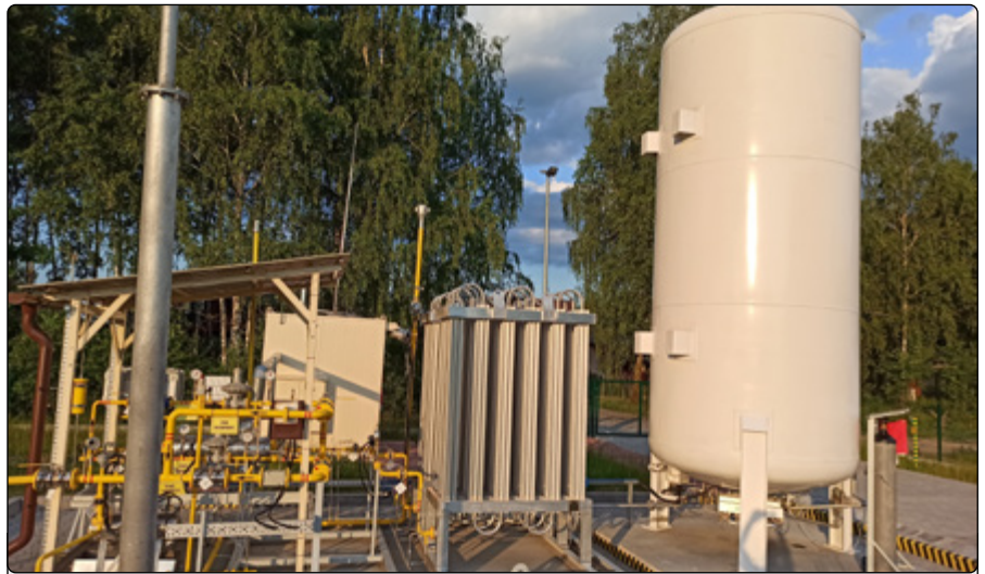
Stacja wstępnej gazyfikacji w Jednoróżcu
