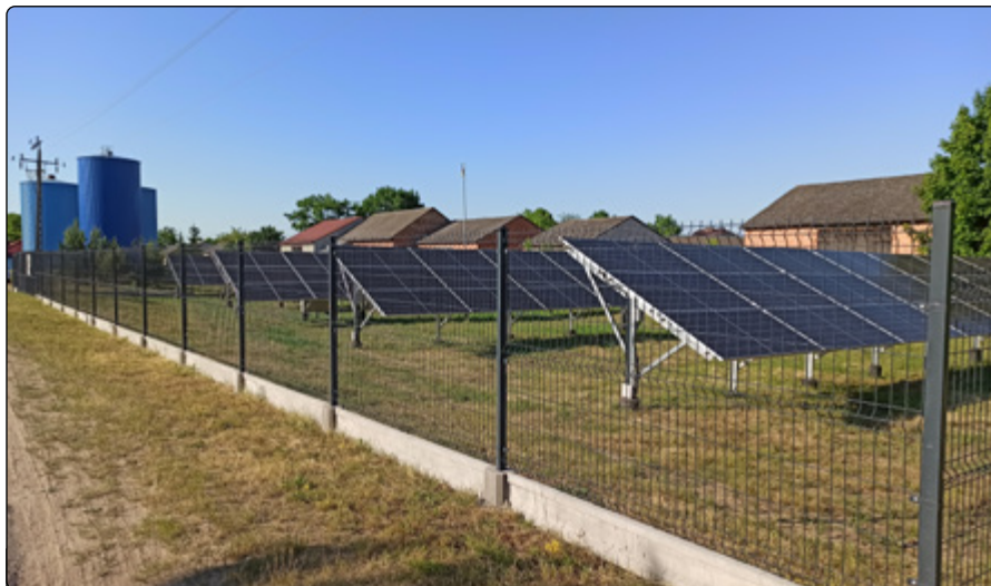
Instalacja fotowoltaiczna przy hydroforni w Jednorozcu
