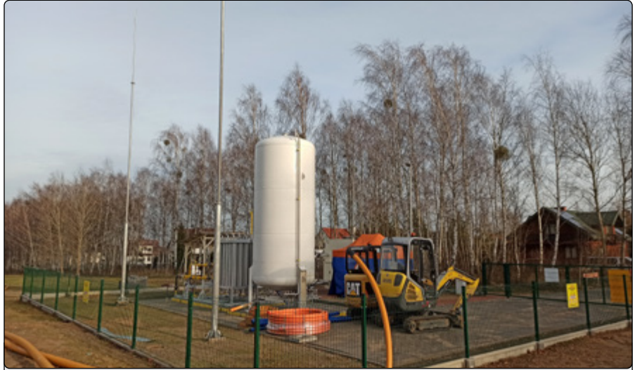
Stacja wstępnej gazyfikacji w Jednorożcu
